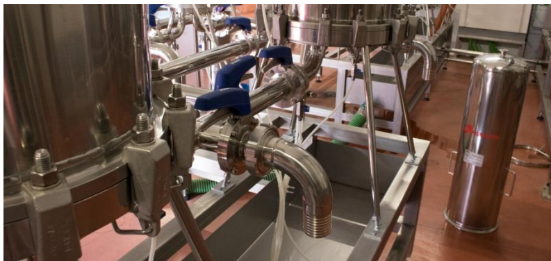
VALVULAS para lavado en contracorriente
